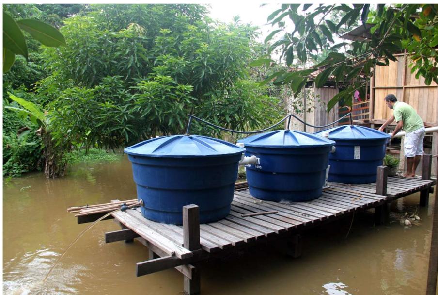
FIGURA 89 - FOSSA SÉPTICA BIODIGESTORA EM USO
