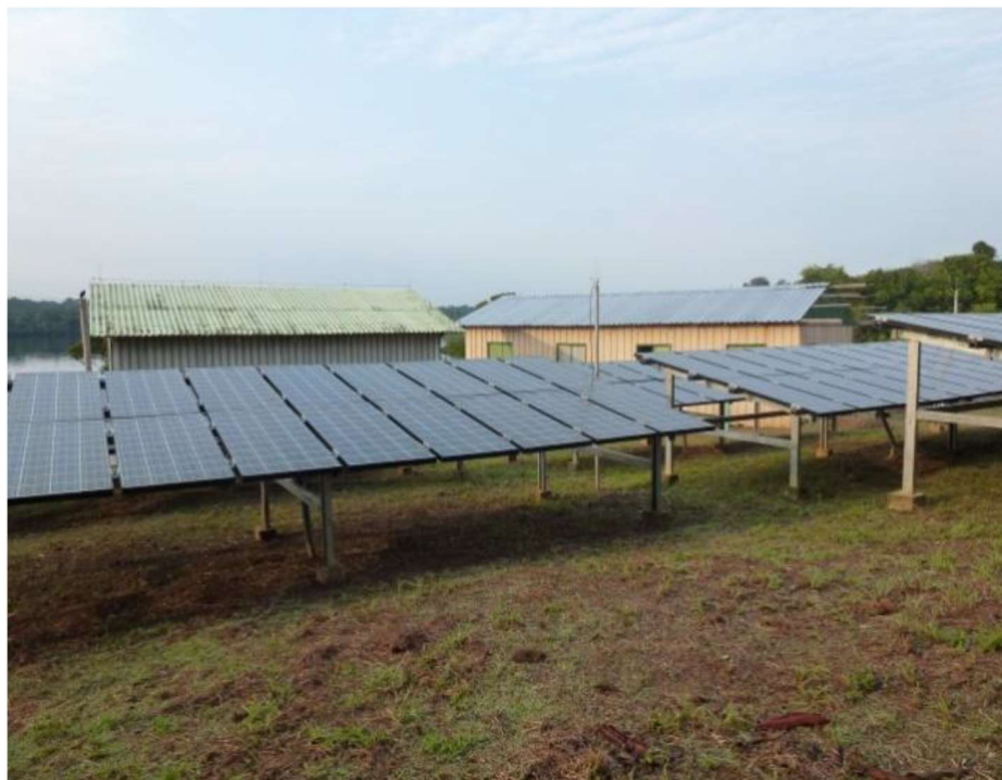
FIGURA 38 - SISTEMA DE PLACAS SOLARES
