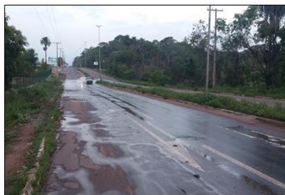
Foto 13: Vista da Rodovia JK – Eixo Sul, motivada pelo alagamento da área de ressaca no condomínio Verana Macapá. Fonte: Trabalho de Campo, 2015.
