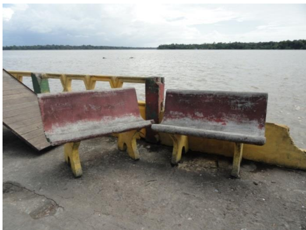
Figura 57 - Degradação no guarda-corpo e bancos.
