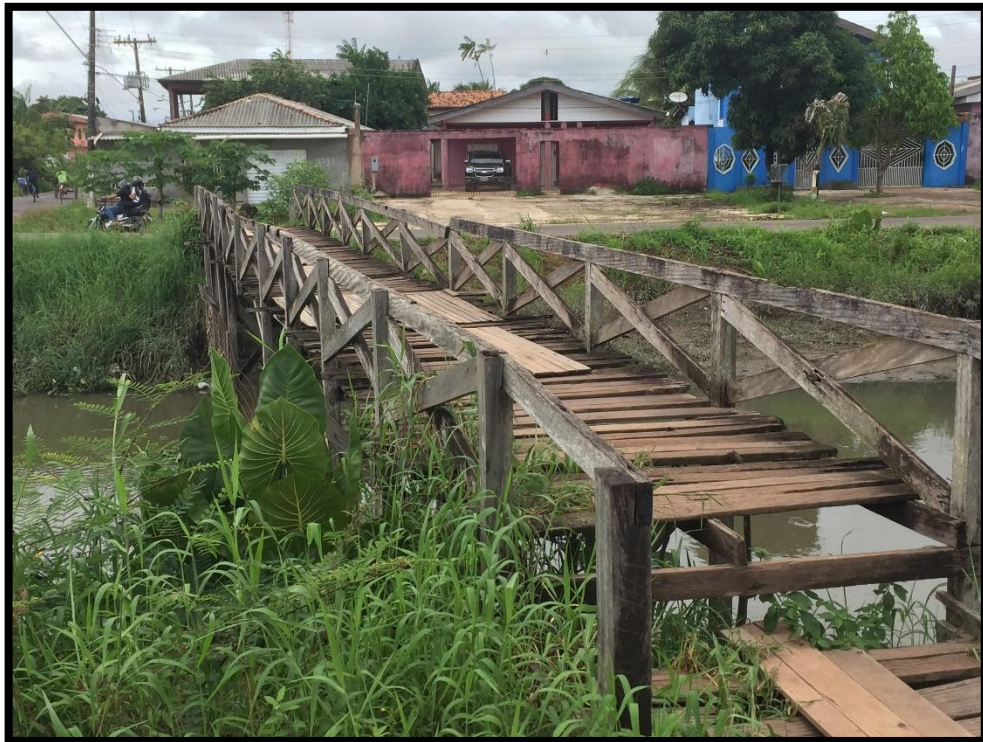
Figura 33 – Ponte em estado de deterioração
