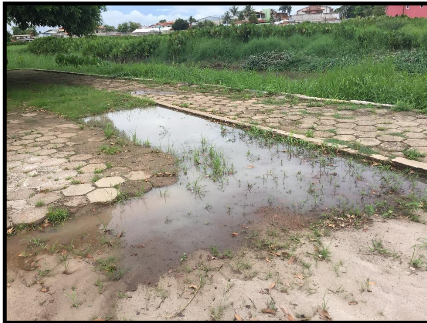
Figura 32 – Poça de água
