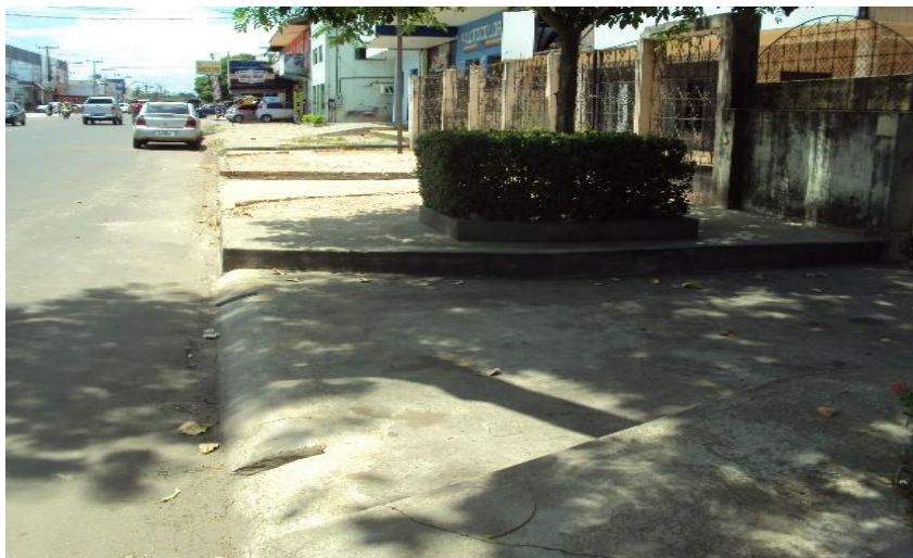
Figura 28 - calçadas em estado regular de conservação
