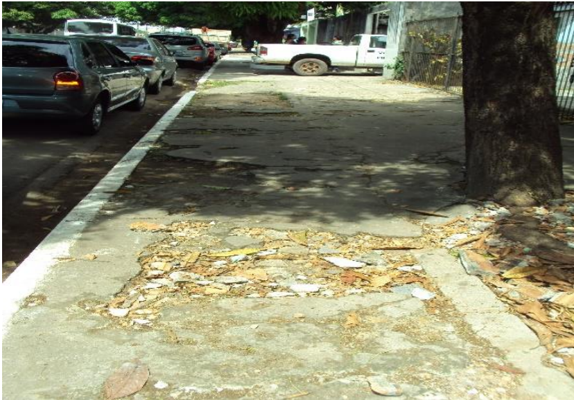
Figura 29 - calçada com estado de conservação ruim
