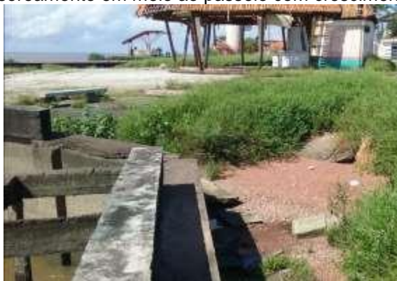
Figura 48 – Assoreamento em meio ao passeio com crescimento de vegetação
