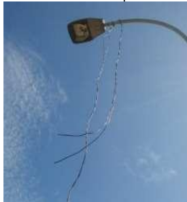
Figura 52 – Furto de fios do poste de iluminação
