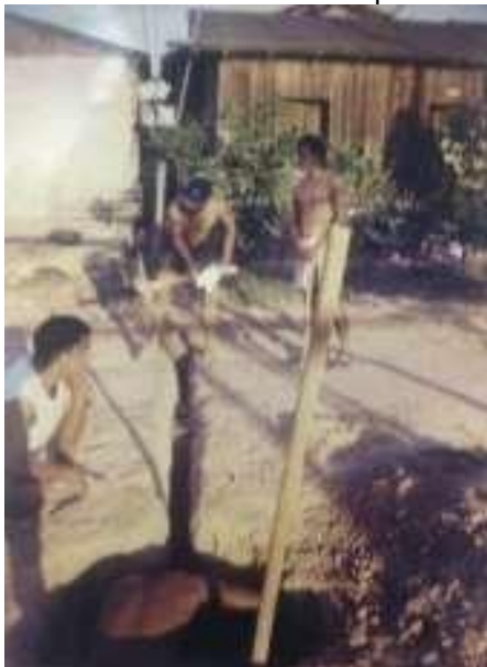
Figura 11 – Encanamento instalado pelos moradores
