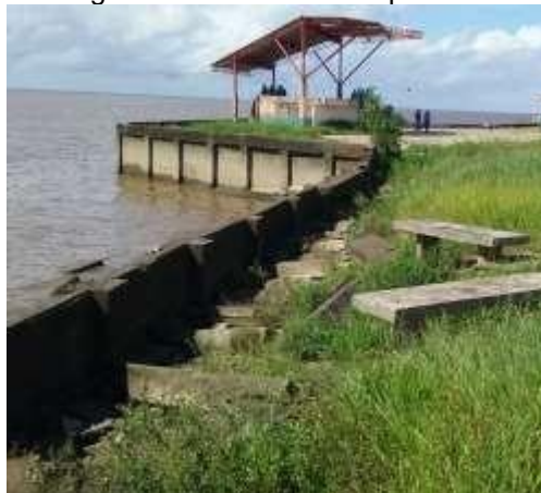
Figura 47 – Ausência de passeio
