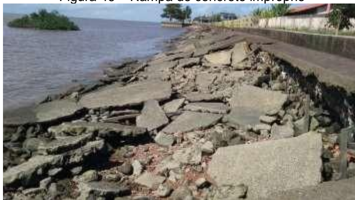
Figura 46 – Rampa de concreto impróprio
