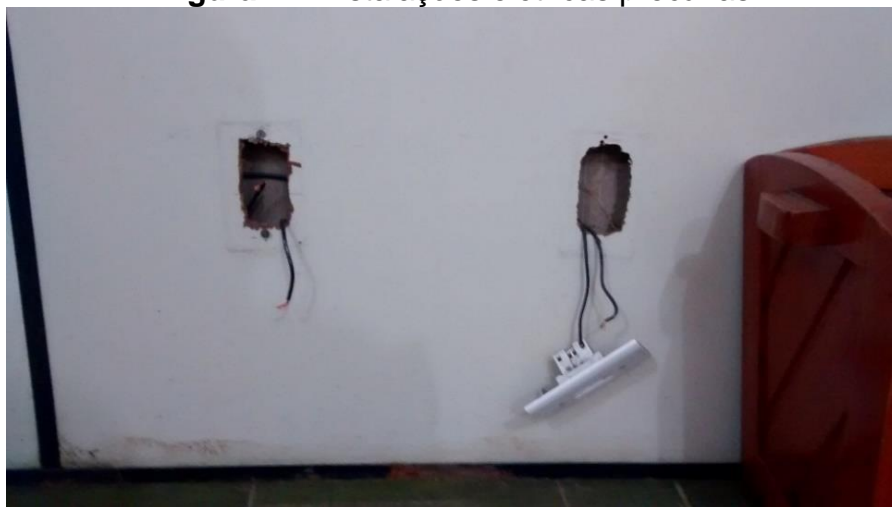
Figura 24 -Instalações elétricas precárias
