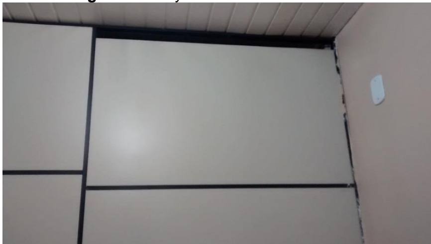
Figura 23 - Drywall das salas danificados
